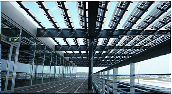
275 kWp Dock E, Flughafen Zürich
