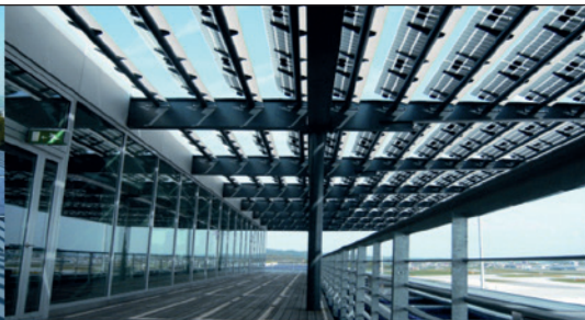
275 kWp Dock E, Flughafen Zürich
