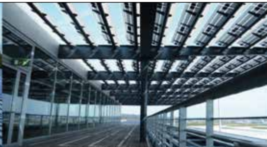
275 kWp Dock E, Flughafen Zürich
